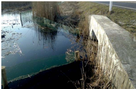
5. ábra: Terelőkerítés hibás csatlakozása ökológiai átjáróhoz a 33. sz. főút hortobágyi szakaszán (fotó: Mester Béla)
